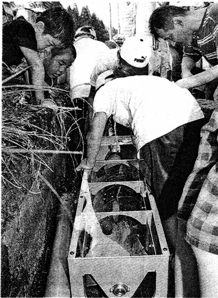
用水路に小型の水力発電機を設置する子どもたち。福井市大手町で
